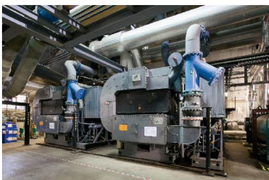
► La instalación aprovecha una parte del vapor que produce la planta de revalorización de residuos sólidos urbanos de TERSA tanto para producir calor como frío.
